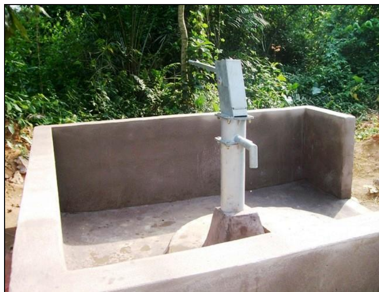
Un puits à motricité humaine à Nyanon
